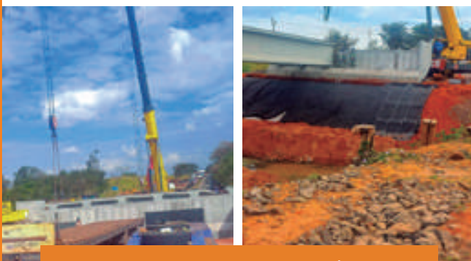
Construção da Ponte sobre o Ribeirão Água Bonita, no município de Quatá
